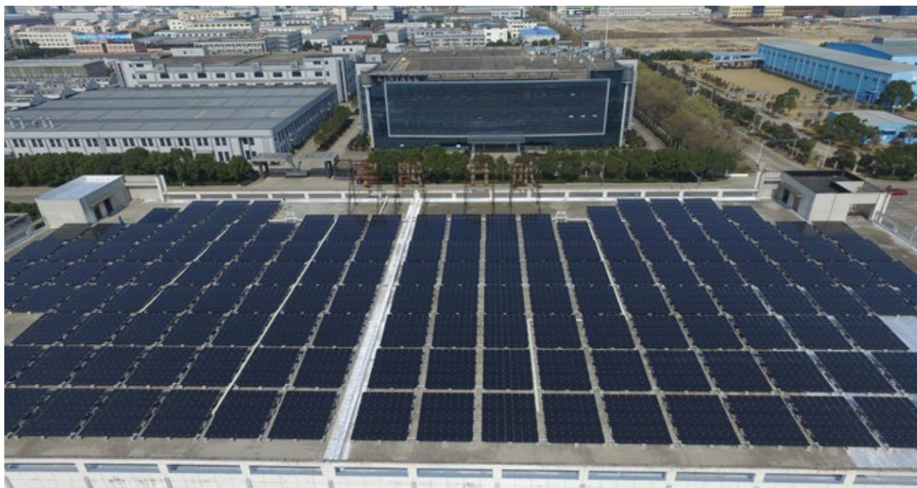
En av ASRE:s anläggningar i Kina, om 1,74 MW. Installerad på Fenghua Xuri Hangyu Co.Ltd.
