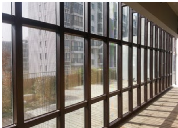
En vägg helt bestående av semitransparenta tunnfilmssolceller av samma typ som marknadsförs av SolTech Energy på skandinaviska marknaden, och som även kan installeras av ASRE i de fall kunden uppför en ny byggnad.
