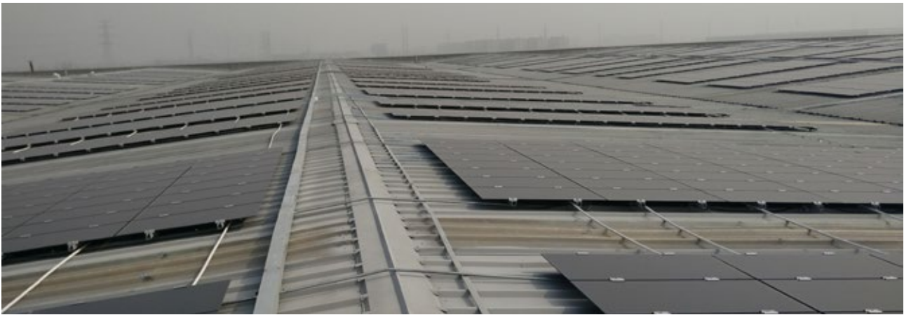
En av ASRE:s anläggningar i Kina, om 4 MW. Installerad på Zhejiang Jindun Fire Control Equipment Co. Ltd.
